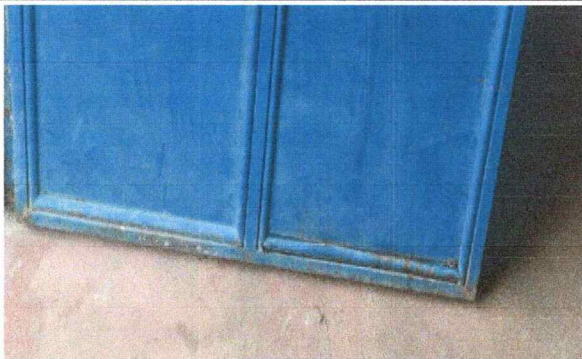
FOTO 3: PORTON PRINCIPAL CON OXIDO EN LA PARTE DE ABAJO.
