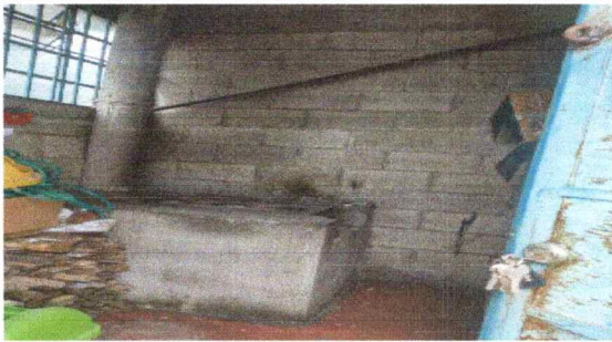
FOTO 5: AREA DE COCINA, PAREDES SIN REPELLO
