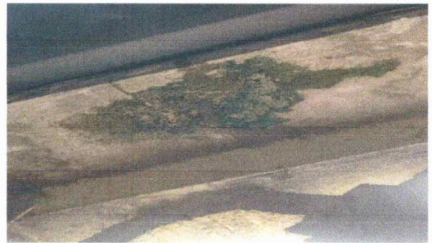
FOTO 4: CANAL DE AGUA PLUVIAL CON FILTRACION.
