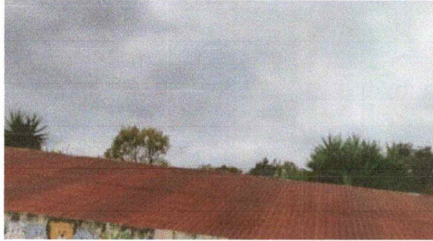
FOTO 1: ENTECHADO, LAMINAS EN SU TOTALIDAD EN MAL ESTADO.
